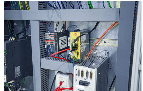
Das Gateway wurde in den Schaltschrank einer Maschine eingebaut und diese mit der zweiten Anlage vernetzt, sodass das Gateway gleichzeitig die Steuerungsdaten beider Automaten verarbeiten kann. (Bild: ipf electronic gmbh)
