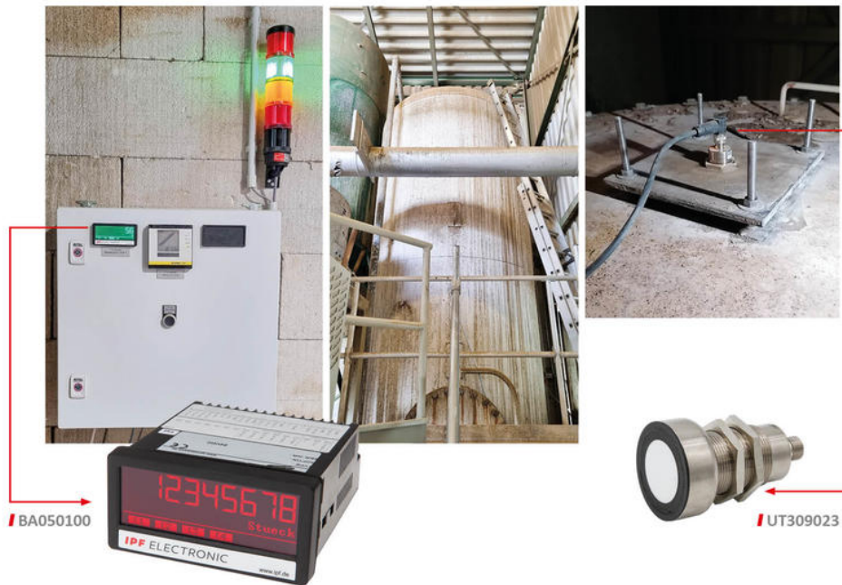
Der Ultraschalltaster wurde im Deckelbereich eines Silobehälters montiert (rechts). Der Messumformer (links) befindet sich in einem Schaltschrank, in der Nähe des Silos (Mitte).
