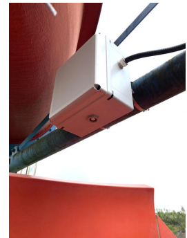
Der Ultraschallsensor wurde oberhalb der Rutsche montiert und war danach nur schwer erreichbar. Da aber das Analogsignal (4...20mA) direkt in der Steuerung ausgewertet werden konnte, ließ sich der Arbeitsbereich des Sensors sehr komfortabel einstellen, ohne hierzu ständig die Rutsche betreten zu müssen. (Foto: Martinrea Bergneustadt GmbH)
