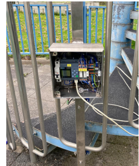
Die Signalauswertung und -weiterverarbeitung der beiden Sensoren übernimmt eine mit der RGB-LED-Signalleuchte verbundene Siemens Logo, wobei Julian Hooge hier auch die komplette Verdrahtung übernahm. (Foto: Martinrea Bergneustadt GmbH)
