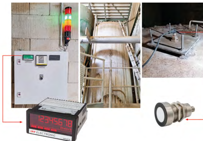
Abb. 29: Der Ultraschalltaster wurde im Deckelbereich eines Silobehälters montiert (rechts). Der Messumformer (links) befindet sich in einem Schaltschrank, in der Nähe des Silos (Mitte).
