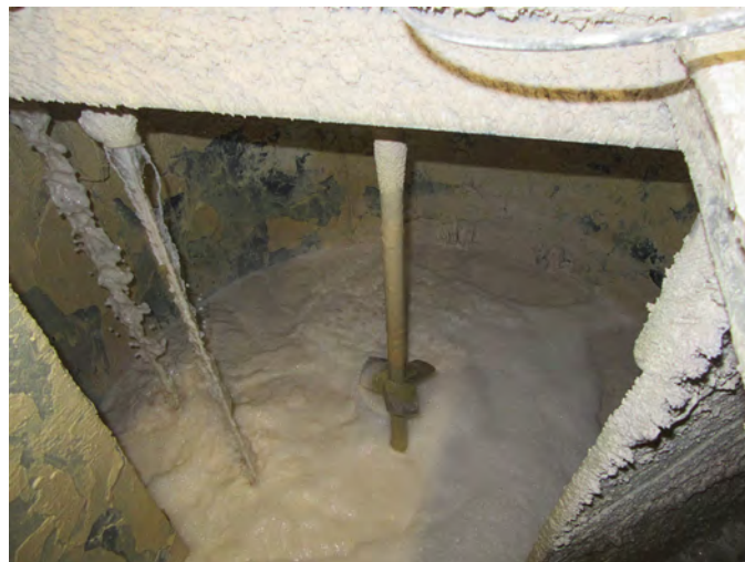
Abb. 34: Blick in den Kalkmilchbehälter. Links vom Mischer ist die Stabsonde zu sehen, an der sich auch nach längerem Betrieb nur wenig Kalk ablagert.
