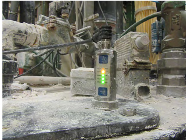
Abb. 33: Gehäuse und Anschluss des kapazitiven Füllstandsensors bestehen aus Edelstahl. Deutlich erkennbar sind die Kalkablagerungen auch auf dem Behälter der Aufbereitung.
