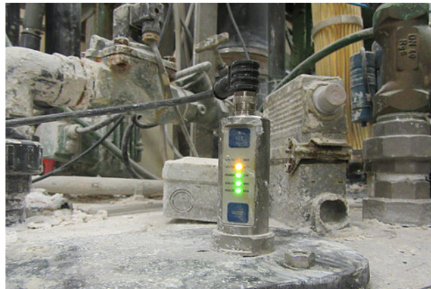
Das Gehäuse und der Anschluss des kapazitiven Füllstandssensors bestehen aus Edelstahl. Deutlich erkennbar sind die Kalkablagerungen auch auf dem Behälter der Aufbereitung.
