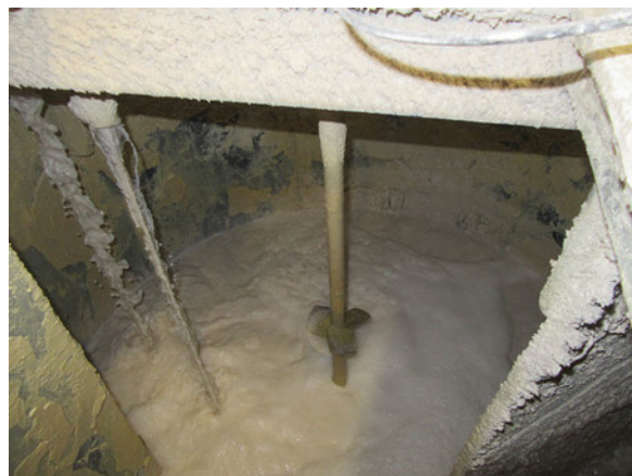
Im Behälter wird der Kalk mit Wasser zu Kalkmilch angemischt. Links vom Mischer ist die Stabsonde aus PTFE zu sehen, an der sich auch nach längerem Betrieb nur wenig Kalk abgelagert.
