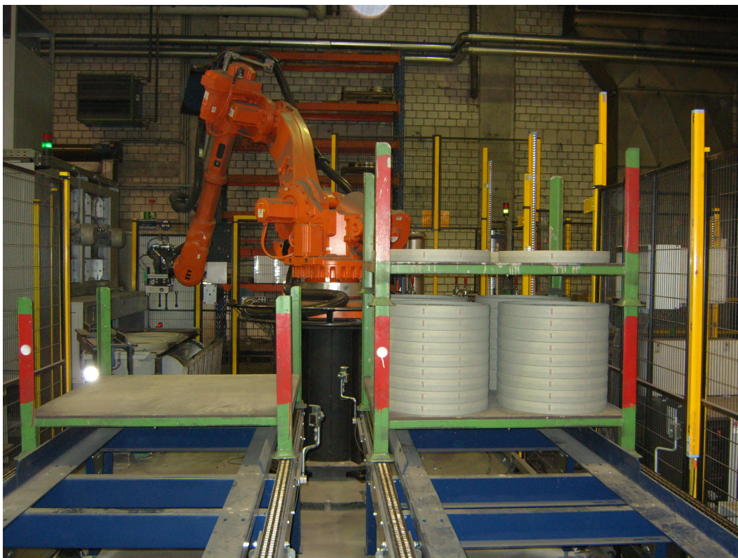
Automatizované ukládání pásu do pece Obrázek: ipf electronic
