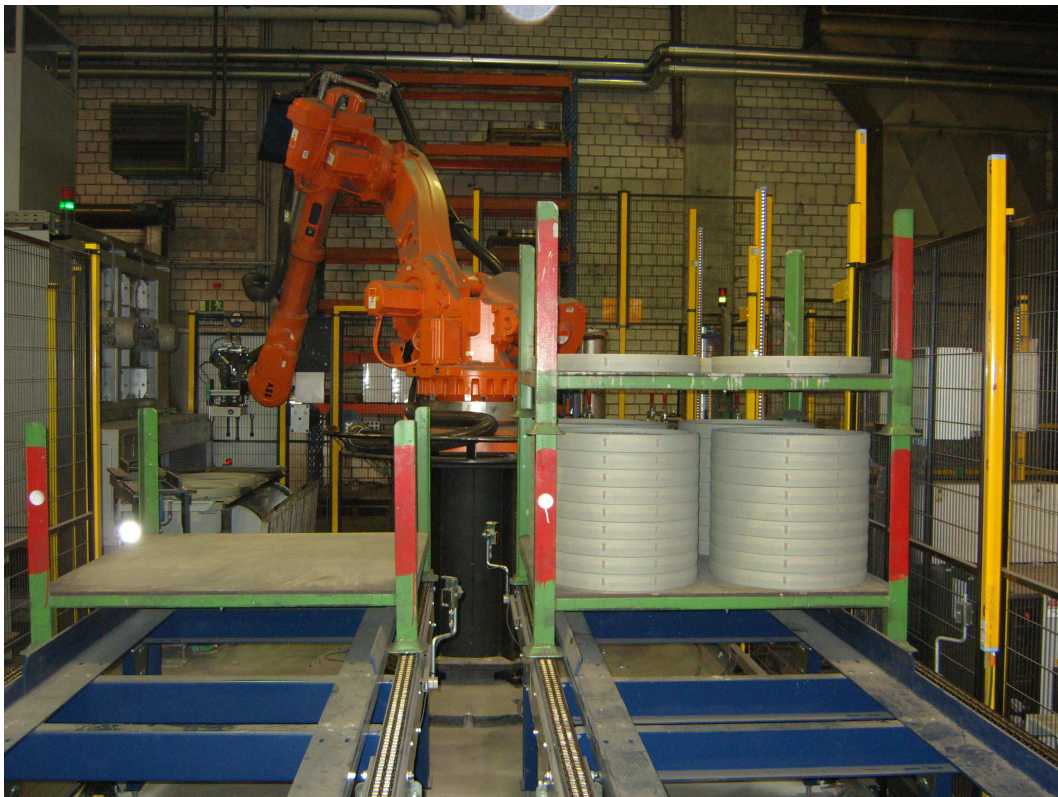
Équipement automatisé d'une bande de four Photo : ipf electronic
