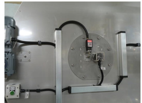
Detalle del sensor de presión para el control del nivel por encima del vellón filtrante.
