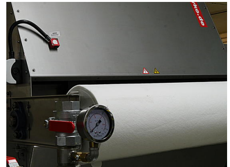
Lado de entrada del vellón filtrante: Un sensor óptico de ipf electronic supervisa la presencia del vellón filtrante con una señal de presencia permanente. Si el vellón filtrante se agota, la señal del sensor desaparece, indicando al PLC del sistema que es necesario insertar vellón nuevo.
