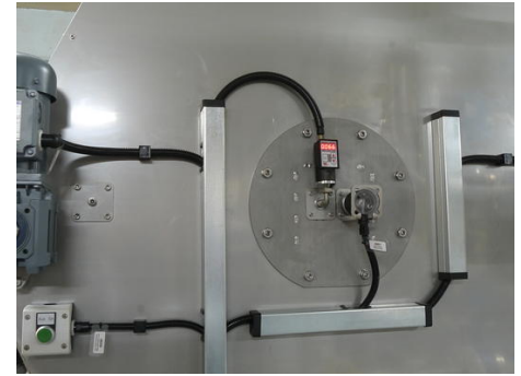
Vue détaillée du capteur de pression pour le contrôle du niveau de remplissage au-dessus du non-tissé filtrant.
