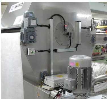
Installation de filtration avec un capteur de pression (au centre de l'image) pour contrôler le niveau de remplissage. Lorsque le non-tissé filtrant a atteint sa capacité d'absorption, le liquide à filtrer s'accumule au-dessus du non-tissé. Le capteur de pression signale ce phénomène à la commande de l'installation, de sorte que la partie encrassée du filtre est évacuée de l'installation.
