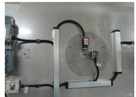
Zbliżenie czujnika ciśnienia do kontroli poziomu nad włókniną filtracyjną.
