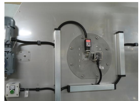
Grande plano do sensor de pressão para controlo do nível acima do velo do filtro.
