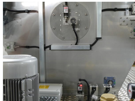
..... (英文 DW35311A (下图)。该设备发出的模拟信号可与连续动态压力测量信号并行使用，从而确定水箱中的液位，并与过滤系统的 PLC 相连接，以便通过变频器永久控制泵驱动器 (图中左侧)。
