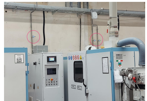
Das Druckluftmonitoring direkt an den Anlagen ermöglicht es, Probleme gezielter zu identifizieren und schneller zu reagieren, um geeignete Maßnahmen gegen die Druckluftverschwendung zu ergreifen.
