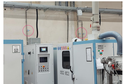
La supervisión del aire comprimido directamente en las instalaciones permite detectar los problemas de forma más específica y reaccionar con mayor rapidez para tomar las medidas adecuadas contra el derroche de aire comprimido.
