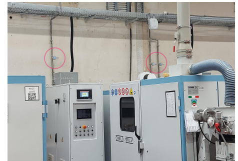
Le monitoring de l'air comprimé directement sur les installations permet d'identifier les problèmes de manière plus ciblée et de réagir plus rapidement afin de prendre les mesures appropriées contre le gaspillage d'air comprimé.
