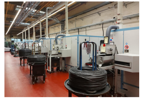
Une grande partie des capteurs est utilisée sur les machines de l'atelier de pressage de SPAX, car les installations ont un grand besoin d'air comprimé.
