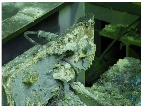
Kyselá skvrna působí na laserové světelné závory v nárazníkových zónách velmi tvrdě, jak je zřetelně vidět, ale senzory, které byly instalovány těsně nad válečkovými dopravníky, stále spolehlivě fungují.
