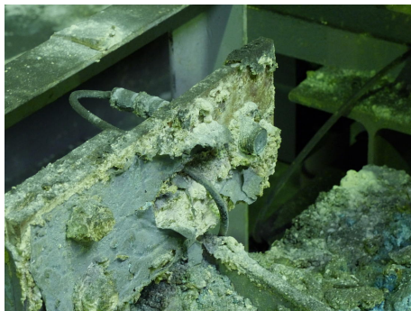
Die säurehaltige Beize setzt den Laserlichtschranken in den Pufferzonen extrem zu, wie deutlich zu erkennen ist, dennoch arbeiten die Sensoren, die knapp oberhalb der Rollengänge installiert wurden, zuverlässig.
