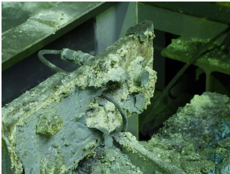
Jak wyraźnie widać, kwaśna plama jest bardzo szkodliwa dla laserowych barier świetlnych w strefach buforowych, ale czujniki, które zostały zainstalowane tuż nad przenośnikami rolkowymi, nadal działają niezawodnie.
