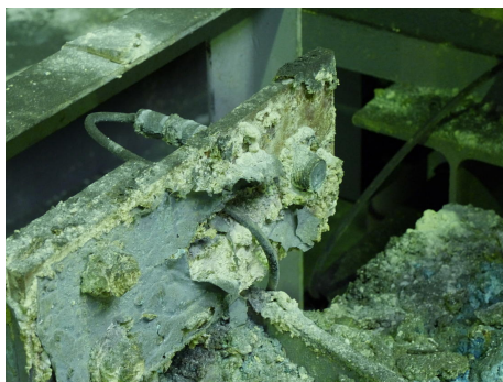
A mancha ácida é extremamente dura para as barreiras de luz laser nas zonas tampão, como se pode ver claramente, mas os sensores, que foram instalados mesmo por cima dos transportadores de rolos, continuam a funcionar de forma fiável.
