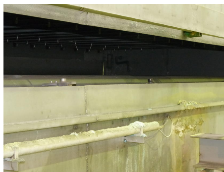
Três sensores indutivos operados em paralelo estão posicionados na entrada e na saída da câmara de decapagem. A disposição especial garante que uma área maior da placa de cobre possa ser digitalizada a partir da parte inferior e, portanto, pelo menos um sensor responde.
