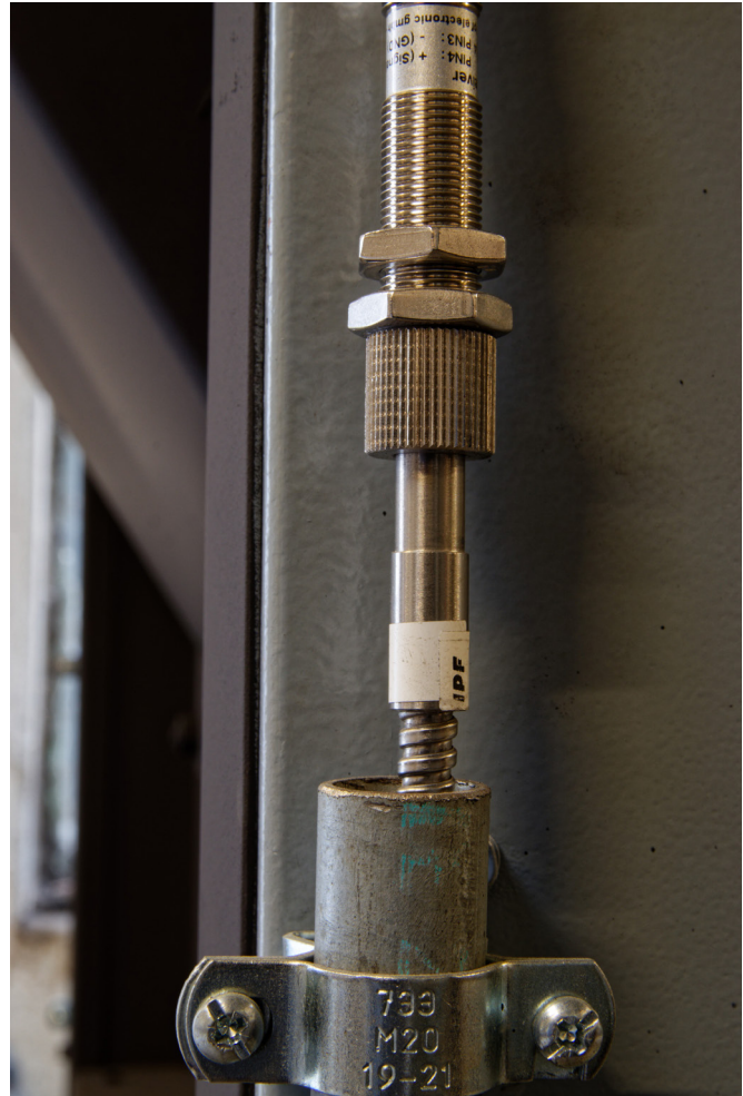
Der Empfänger der Lichtschranke, angeschlossen an einen, mit einer Metallummantelung geschützten Lichtleiter, ist in einem Bereich des Ofens installiert, dessen Umgebungstemperaturen für die Elektronik unproblematisch sind. (Bild: ipf electronic)
