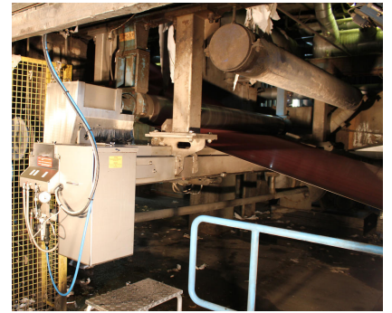
Vue d'une machine à papier. À droite, on peut voir une partie de la toile de la machine soutenue par des rouleaux. (Image : IBS Paper Performance Group)
