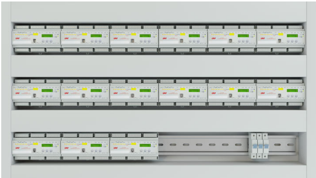
Die steckbaren Sende- und Empfangselemente wurden über konventionelle Sensorleitungen an 20 Auswerteeinheiten angeschlossen, die sich in einem separaten Schaltschrank befinden. Die Verstärker ermöglichen eine manuelle als auch automatische Einstellung (für eine hohe Verschmutzungskompensation) der Sendeleistung.
