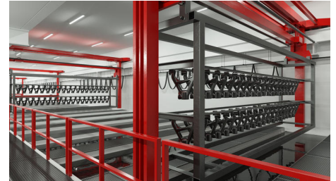
El proceso completo de revestimiento catódico por inmersión requiere un total de 12 pasos individuales y consta de varios tanques de gran volumen dispuestos uno detrás de otro. (Todas las imágenes: ipf electronic gmbh)
