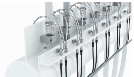
Hubo que instalar un total de 312 guías de luz de fibra óptica revestidas de metal en los tubos de vidrio a la vuelta del KTL, que se fijaron a los transmisores y receptores individuales.
