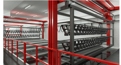
Cały proces katodowego powlekania zanurzeniowego wymaga łącznie 12 poszczególnych etapów procesu i składa się z kilku zbiorników o dużej objętości, umieszczonych jeden za drugim. (Wszystkie zdjęcia: ipf electronic gmbh)
