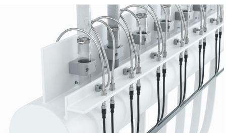
Łącznie 312 światłowodów pokrytych metalem musiało zostać zainstalowanych na szklanych rurach na powrocie KTL, które zostały podłączone do poszczególnych nadajników i odbiorników.
