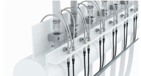
在 KTL 返回端的玻璃管上共安装了 312 个金属外壳光纤导光板，这些导光板与各个发射器和接收器相连。
