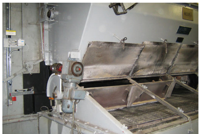
ipf_FHW_Neukoelln002: Die Infrarotsensoren und separaten Auswerteeinheiten wurden seitlich des Wanderrostes (im Bild links) installiert.
