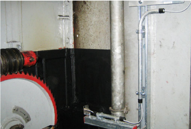
ipf_FHW_Neukoelln003: Der auf einem Profil befestigte Infrarotmesskopf des Sensorsystems OI98A920 in Schutzart IP65 zählt zu den kleinsten weltweit (Bild Mitte, unten) und erfasst im FHW Neukölln in einem Abstand von 300mm berührungslos die Temperatur der Wandung am Aufgabetrichter mit einer Auflösung von 22:1.
