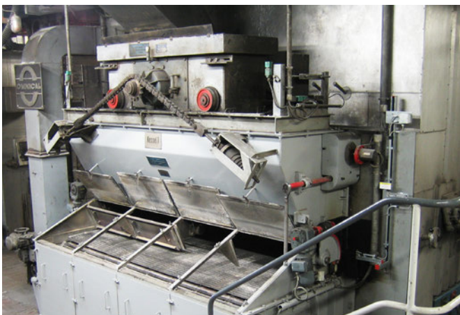
ipf_FHW_Neukoelln001: Der Aufgabetrichter für den Brennstoff befindet sich direkt vor dem Heizkessel (im Hintergrund) über dem Wanderrost.
