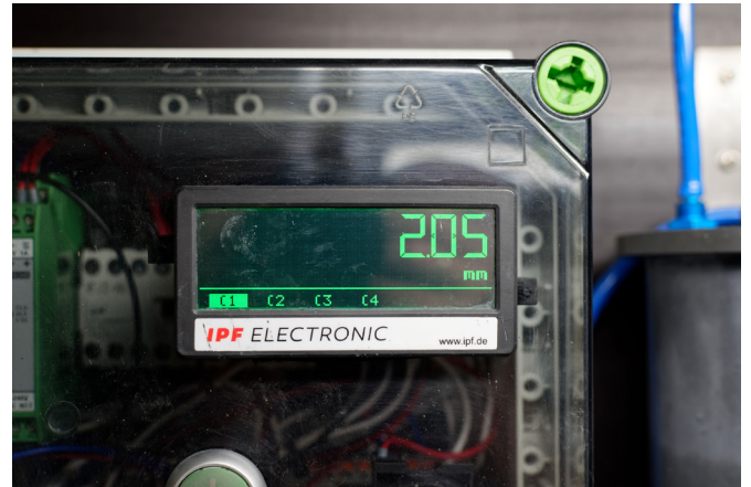
Im Impulswächter sind derzeit vier per Tastendruck wählbare Einpressmaße (C1 bis C4) für die Negativmatrizen hinterlegt. Das Fronttafelgerät visualisiert das jeweils aktuelle Maß für den Vortrieb mit grünen Ziffern. Die Anzeige wechselt auf Rot, wenn der Sollwert für die Tiefe der Matrize erreicht ist. (Bild: ipf electronic)
