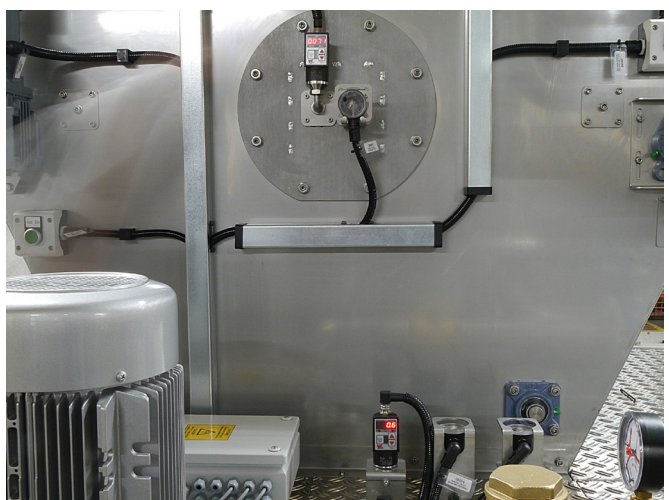
Der DW35311A (Bild, unten). Die analogen Signale dieses Gerätes lassen sich parallel zur kontinuierlichen Staudruckmessung und somit Füllstandsbestimmung in einem Becken dazu nutzen, die SPS der Filteranlage anzusprechen, um einen Pumpenantrieb (im Bild links) über einen Frequenzumrichter permanent zu regeln.
