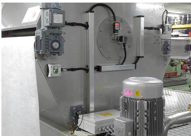
Filteranlage mit einem Drucksensor (Bildmitte) zur Füllstandskontrolle. Hat das Filtervlies seine Aufnahmekapazität erreicht, staut sich die zu filternde Flüssigkeit oberhalb des Vlieses. Der Drucksensor meldet dies an die Anlagensteuerung, sodass dass der verschmutzte Teil des Filters aus der Anlage befördert wird.
