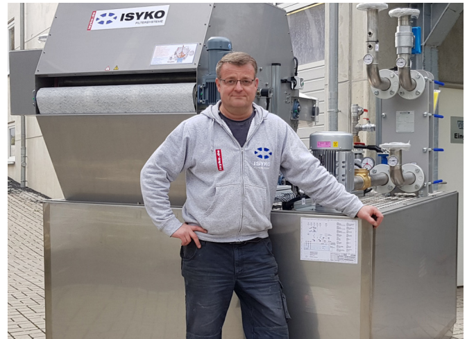
Volker Koczkowski, Geschäftsführer der ISYKO Filtersysteme: „Mit der permanenten Regelung erreichen wir, dass die Pumpe in Abhängigkeit zum Flüssigkeitsstand in einem Behälter ihre Förderleistung stets anpasst. Insbesondere bei einem hohen Fördervolumen können mit den analogen Drucksensoren die häufig auftretenden Ein- und Ausschaltzyklen, wie sie für digitale Drucksensoren typisch sind, vermieden werden, die letztendlich auch einen höheren Verschleiß der Pumpe bedeuten.“
