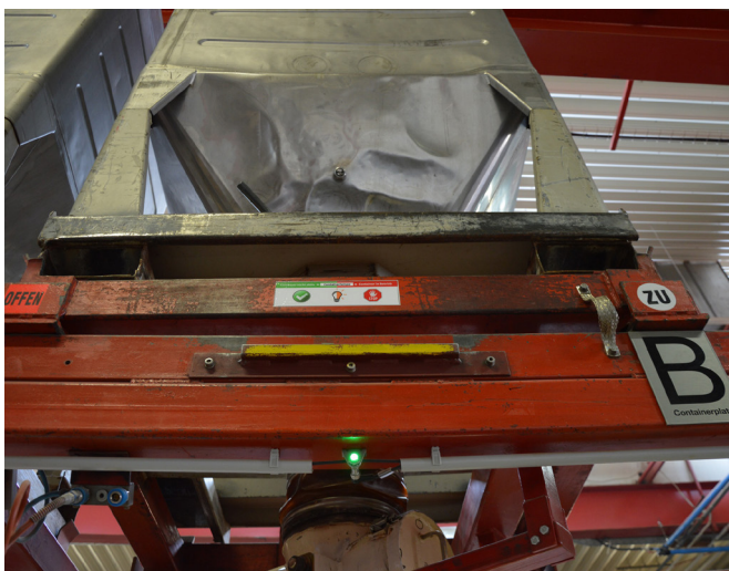
Einfache, kompakte und zielführende Lösung: Unterhalb der Rohmaterialbehälter befinden sich die LED-Bicolor-Leuchten. Ein grünes Licht signalisiert dem Staplerfahrer den auszutauschenden Rohmaterialbehälter.
