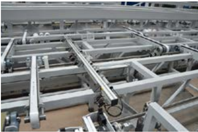
Ve všech částech řešení automatizace, v kterých probíhá manipulace s vyrovnávacími zásobníky nebo taktování dílů, je použito celkem 25 optických senzorů typu OT430370.
