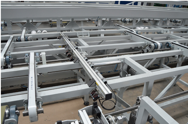
Insgesamt 25 optische Sensoren vom Typ OT430370 sind in allen Bereichen der Automationslösung im Einsatz, in denen die Werkstücke gepuffert oder aufgetaktet werden.
