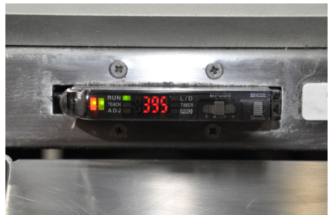
Detailsicht des Verstärkers. Der angezeigte Wert gibt die Signalstärke der Lichtschranke bei Unterbrechung des Lichtsignals wieder.
