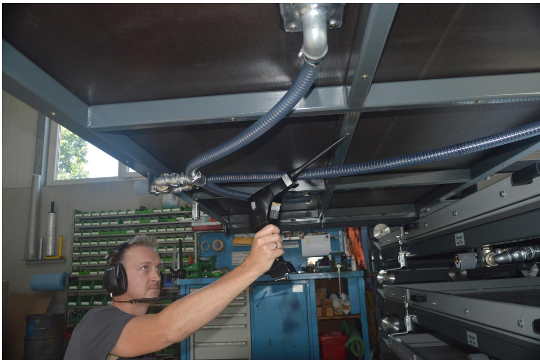
S redukcí zvuku a sluchátky pro UY000003 od společnosti IPF lze lokalizovat nejmenší ztráty vakua pod vakuovým stolem, jak je znázorněno na šroubení. Odhaduje se, že na stroji je třeba zkontrolovat až 100 zkušebních bodů.
