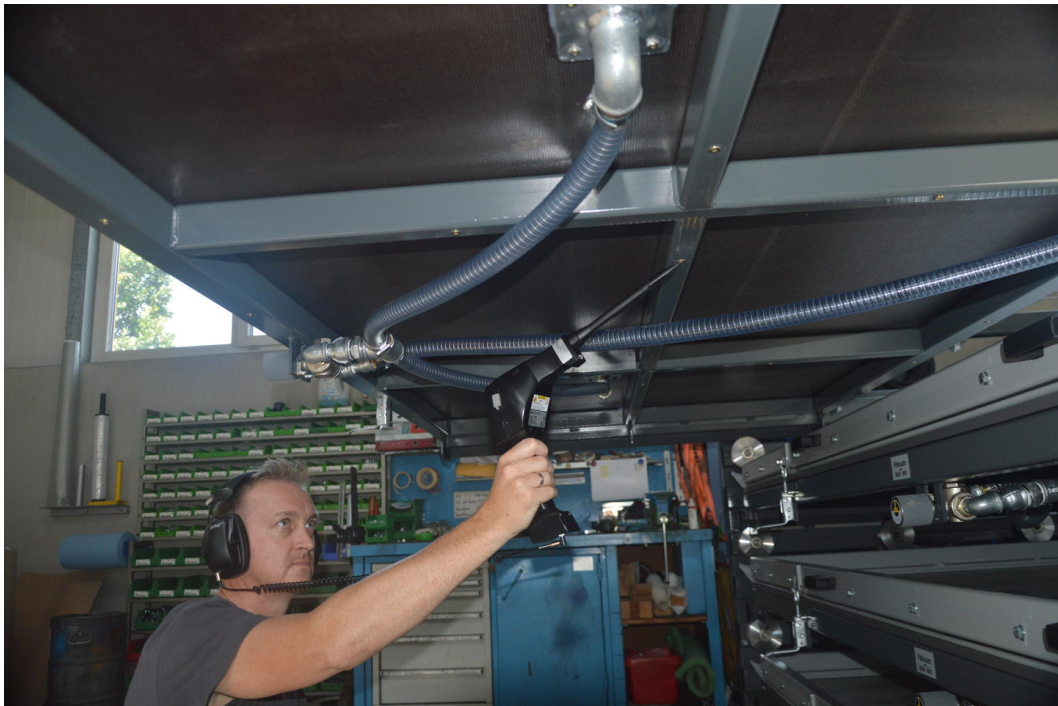
Mit dem Schallreduzierstück und dem Kopfhörer zum UY000003 von IPF lassen sich kleinste Vakuumverluste unterhalb des Vakuumtisches wie hier an einer Verschraubung orten. Schätzungsweise bis zu 100 Prüfstellen müssen an der Maschine kontrolliert werden.
