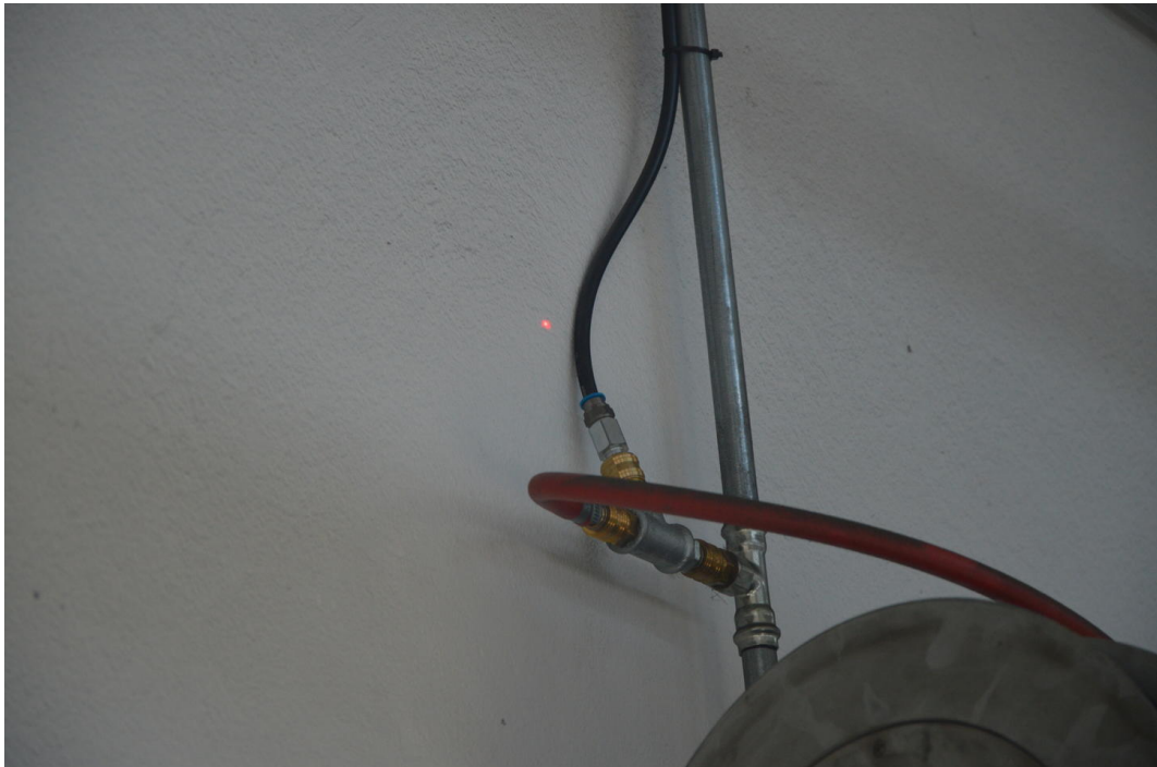
检测压缩空气管道是否泄漏。检漏仪具有激光测距功能，可以更容易地找到潜在的泄漏点。此外，飞行时间测量与设备接收到的超声波信号强度相结合，可用于精确量化压缩空气损失。
