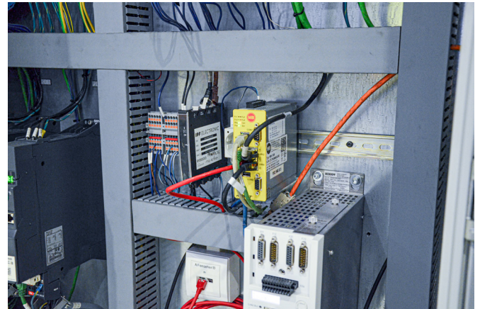
Das Gateway wurde in den Schaltschrank einer Maschine eingebaut und diese mit der zweiten Anlage vernetzt, sodass das Gateway gleichzeitig die Steuerungsdaten beider Automaten verarbeiten kann. (Bild: ipf electronic gmbh)
