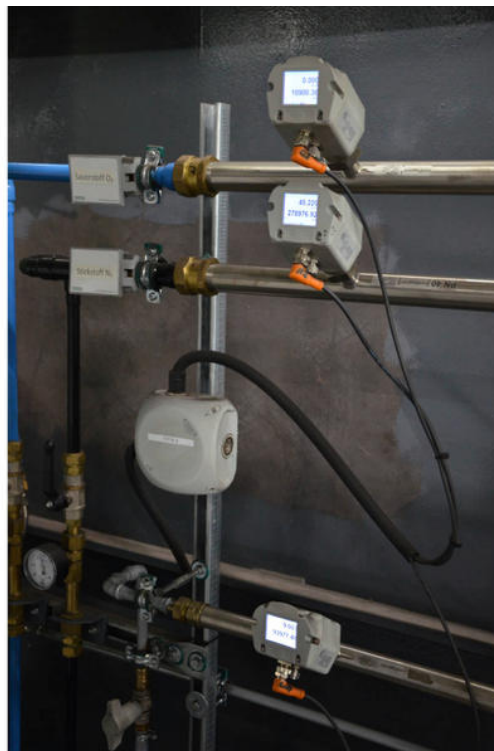
Měření spotřeby na laserovém řezacím systému ve společnosti Kettenwulf: SY92E297 (nahore) pro měření kyslíku, zařízení SY92E296 (uprostřed) (referenční médium dusík) a SL910020 (dole) pro stlačený vzduch.
