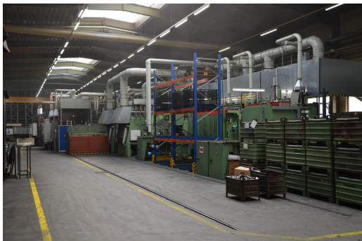
Département avec des besoins élevés en azote : l'atelier de trempage interne de Kettenwulf.
