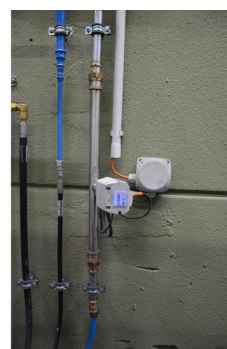
第三台激光切割机必须配备 SL950020 只需确定压缩空气的消耗量，因为其他两套系统已经提供了经验值，特别是技术气体的消耗量。
