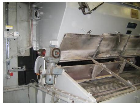
Infračervené senzory a samostatné vyhodnocovací jednotky byly instalovány na boční straně pohyblivého roštu (na obrázku vlevo).
