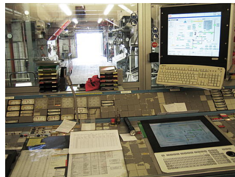
Výstrahy nebo alarmy jsou přenášeny pro každý kotel zvlášť, a to jak vizuálními zprávami na monitoru, tak akustickými signály do řídicí stanice (foto).
