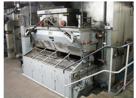
Zásobník paliva je umístěn přímo před kotlem (v pozadí) přes pojezdový rošt.
