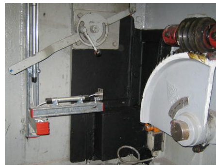
Da auf jeder Seite des Aufgabetrichters unterschiedliche Temperaturen entstehen, wurde auf jeder Trichterseite (hier links) ein Infrarot-Sensor zur Überwachung installiert.
