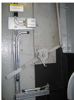
Die Sensoren erfassen die Außentemperaturen der Trichterwandungen und übermitteln ihr Messsignal an die separate Auswerteeinheit. Sie wandelt diese Informationen in analoge Stromsignale, die über I/O-Baugruppen ausgelesen und an der Anlagensteuerung im Leitstand je nach Temperaturverlauf als Vorwarnung oder als Alarm ausgegeben werden.
