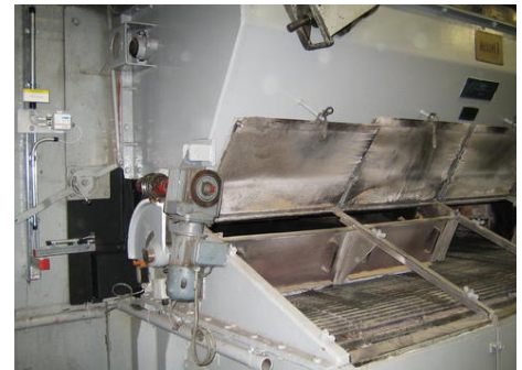
Die Infrarotsensoren und separaten Auswerteeinheiten wurden seitlich des Wanderrostes (im Bild links) installiert.
