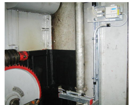
Der auf einem Profil befestigte Infrarotmesskopf des Sensorsystems OI98A920 in Schutzart IP65 zählt zu den kleinsten weltweit (Bild Mitte, unten) und erfasst im FHW Neukölln in einem Abstand von 300mm berührungslos die Temperatur der Wandung am Aufgabetrichter mit einer Auflösung von 22:1.
