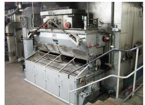
Der Aufgabetrichter für den Brennstoff befindet sich direkt vor dem Heizkessel (im Hintergrund) über dem Wanderrost.
