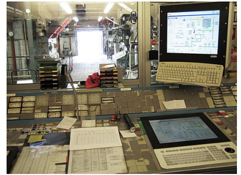
Die Warnungen oder Alarme werden separat für jeden Heizkessel sowohl als optische Meldungen auf einem Monitor als auch als akustische Signale in den Leitstand (Foto) übermittelt.
