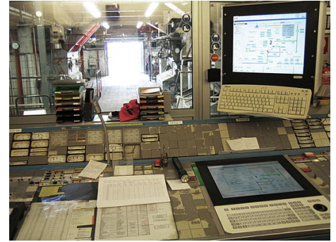
Los avisos o alarmas se transmiten por separado para cada caldera, como mensajes visuales en un monitor y como señales acústicas al centro de control (foto).
