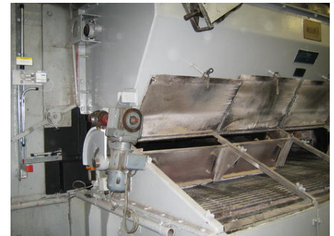
Los sensores infrarrojos y las unidades de evaluación independientes se instalaron en el lateral de la rejilla móvil (a la izquierda en la imagen).
