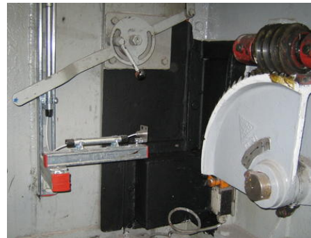
Comme des températures différentes sont générées de chaque côté de la trémie d'alimentation, un capteur infrarouge a été installé sur chaque côté de la trémie (ici à gauche) pour la surveillance.
