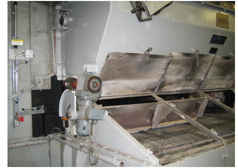
Les capteurs infrarouges et les unités d'évaluation séparées ont été installés sur le côté du caillebotis mobile (à gauche sur la photo).
