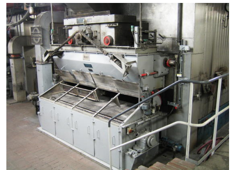
La trémie d'alimentation pour le combustible se trouve directement devant la chaudière (en arrière-plan), au-dessus de la grille mobile.
