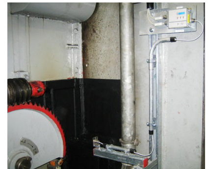
La testa di misura a infrarossi del sistema di sensori montata su un profilo OI98A920 con grado di protezione IP65 è una delle più piccole al mondo (immagine centrale, sotto) e misura la temperatura della parete della tramogga di alimentazione a una distanza di 300 mm con una risoluzione di 22:1.
