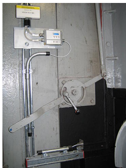
I sensori registrano le temperature esterne delle pareti della tramoggia e trasmettono il segnale di misura all'unità di valutazione separata. Quest'ultima converte queste informazioni in segnali analogici di corrente, che vengono letti tramite moduli I/O e inviati al controllore del sistema nella sala di controllo come avviso anticipato o allarme, a seconda della curva di temperatura.
