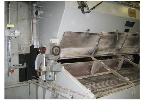
I sensori a infrarossi e le unità di valutazione separate sono stati installati sul lato della griglia mobile (a sinistra nell'immagine).
