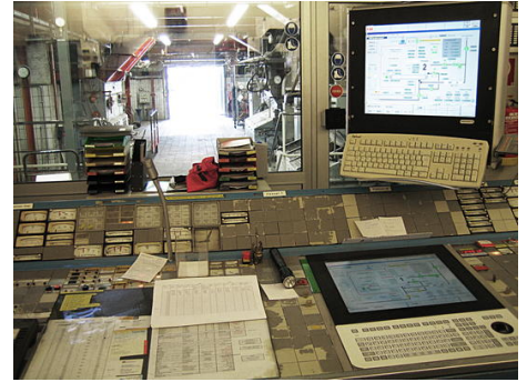
Gli avvisi o gli allarmi vengono trasmessi separatamente per ogni caldaia sia come messaggi visivi su un monitor che come segnali acustici al centro di controllo (foto).
