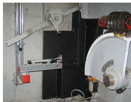
Ponieważ po każdej stronie leja zasypowego generowane są różne temperatury, w celu monitorowania po każdej stronie leja zainstalowano czujnik podczerwieni (tutaj po lewej stronie).
