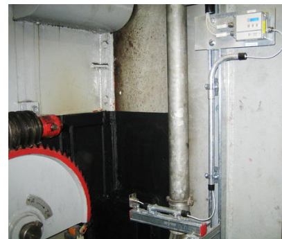
Głowica pomiarowa podczerwieni systemu czujników zamontowana na profilu OI98A920 o stopniu ochrony IP65 jest jedną z najmniejszych na świecie (środkowy obrazek poniżej) i mierzy temperaturę ściany przy koszu zasypowym z odległości 300 mm z rozdzielczością 22:1.
