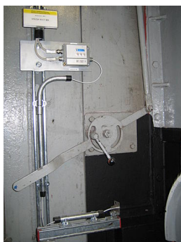
Czujniki rejestrują zewnętrzne temperatury ścian zbiornika i przesyłają sygnał pomiarowy do oddzielnej jednostki analizującej. Przetwarza on te informacje na analogowe sygnały prądowe, które są odczytywane za pośrednictwem modułów I/O i wysyłane do sterownika systemu w pomieszczeniu kontrolnym jako ostrzeżenie lub alarm, w zależności od krzywej temperatury.
