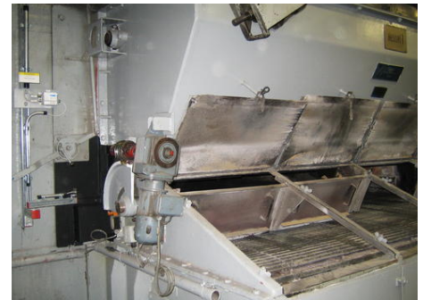
Czujniki podczerwieni i oddzielne jednostki oceniające zostały zainstalowane z boku rusztu jezdnego (po lewej stronie na zdjęciu).
