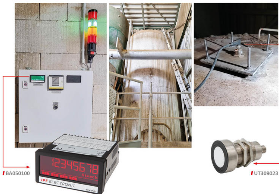
Czujnik ultradźwiękowy został zamontowany w obszarze pokrywy zbiornika silosu (po prawej). Przetwornik (po lewej) znajduje się w szafie sterowniczej w pobliżu silosu (pośrodku).
