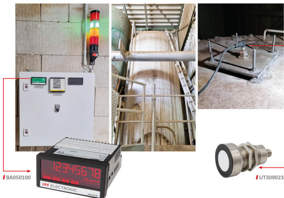
O sensor ultrassónico foi montado na área da tampa de um contentor de silo (direita). O transdutor (esquerda) está localizado num armário de controlo perto do silo (centro).
