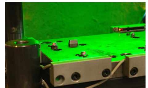
Die Lichtfarbe der Signalleuchte wechselt auf „grün“, sobald die Leuchte die logisch verknüpften UND-Signale der optischen Sensoren erhält. Dann sind sämtliche Bolzen im Werkzeug vorhanden und können in das Bauteil eingepresst werden.
