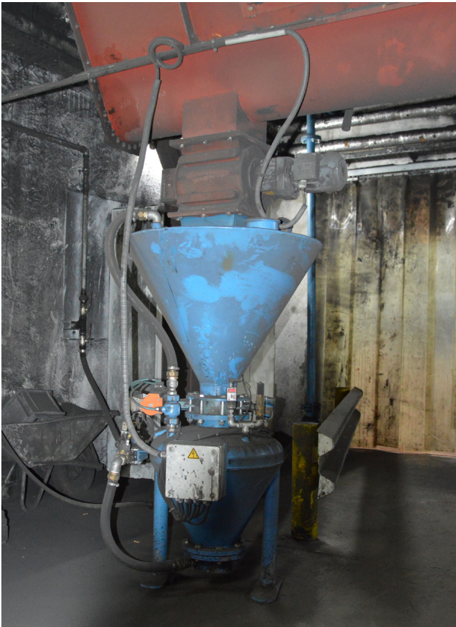
Förderschnecken befördern den Staub aus den Absauganlagen in zwei zentral installierte Sammelbehälter.
