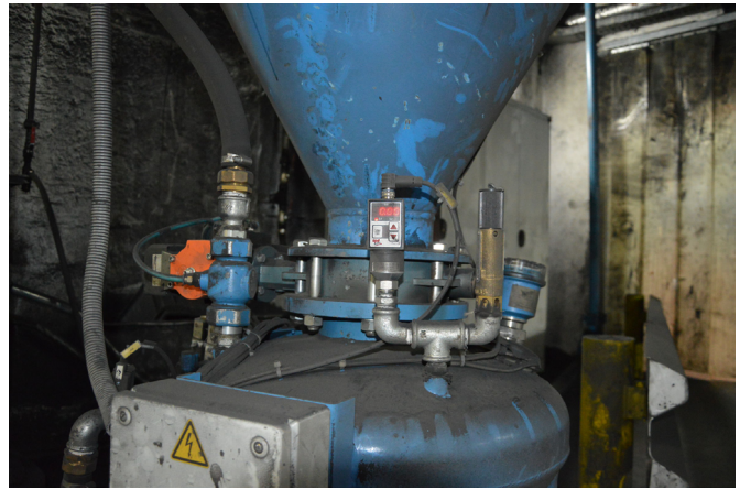
Die Drucksensoren DW35311D überwachen die Rohrleitungen, über die der Staub mittels Pressluft zu einem Silo transportiert wird.
