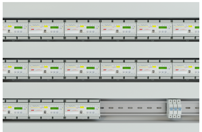
Die steckbaren Sende- und Empfangselemente wurden über konventionelle Sensorleitungen an 20 Auswerteeinheiten angeschlossen, die sich in einem separaten Schaltschrank befinden. Die Verstärker ermöglichen eine manuelle als auch automatische Einstellung (für eine hohe Verschmutzungskompensation) der Sendeleistung.
