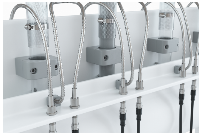
Wird der Infrarotlichtstrahl der Lichtschranke, bestehend aus einem optischen Sender OS126020 und einem optischen Empfänger OE126020, aufgrund einer Eintrübung der Kühlflüssigkeit in einem der Glasröhrchen unterbrochen (zweites Röhrchen von Links), erzeugt der betreffende Auswertekanal der Anschlusseinheit ein Schaltsignal.
